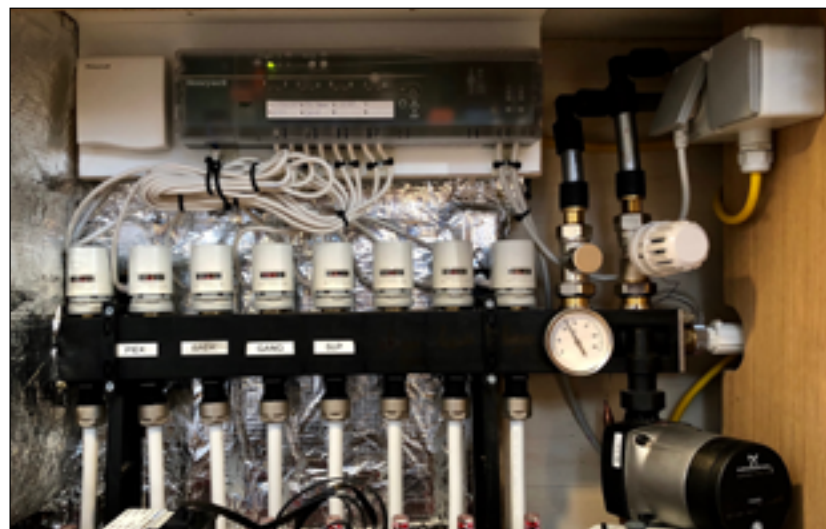
Pompen vloerverwarming naast werkplekken
